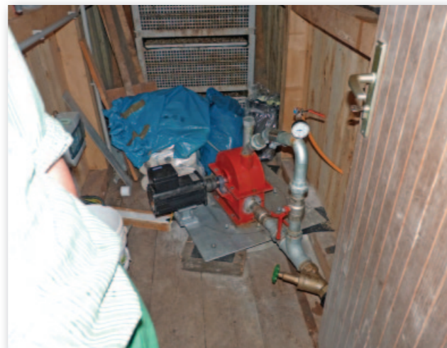
Wasserkraftanlage der Hütte
