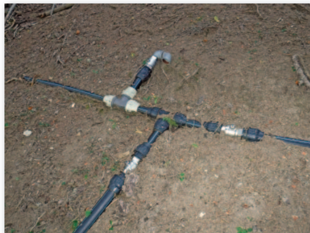
Verzweigung der Rohrleitung nahe Hütte
